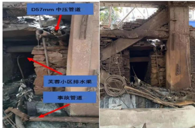
图10 事故管道环境情况
